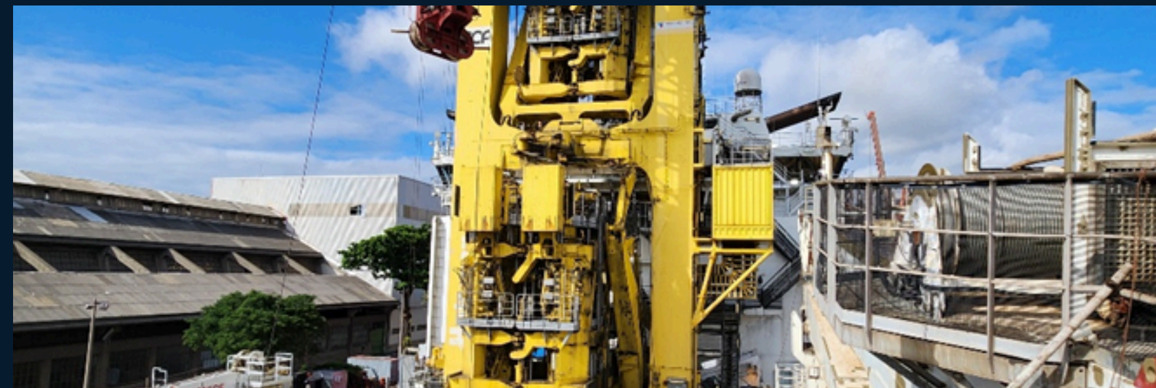
Manutenção de Guinchos TLS
